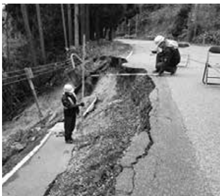
【道路班】法面崩落箇所の被災状況調査
